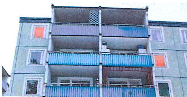
31. Husby, balkonger före renovering
