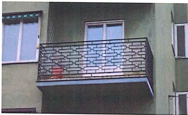
28. Exempel på räcke som säkrats med glas på insidan.
